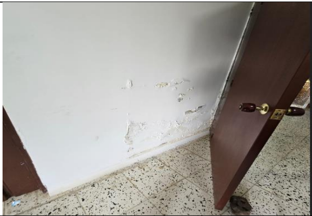
Humedad en consultorio médico continuo al cuarto de aseo
