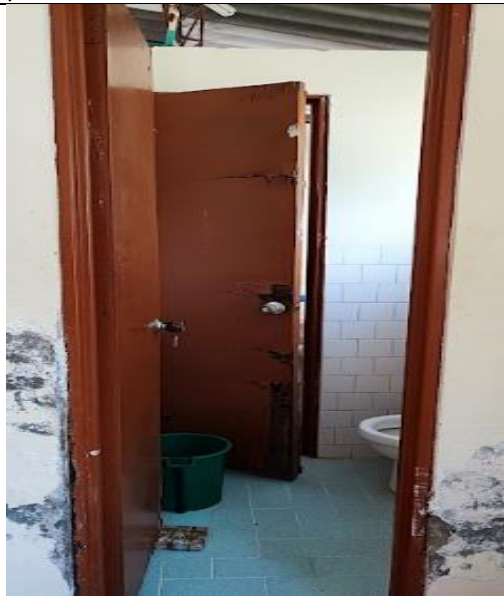
Puerta en mal estado, se requiere cambio
