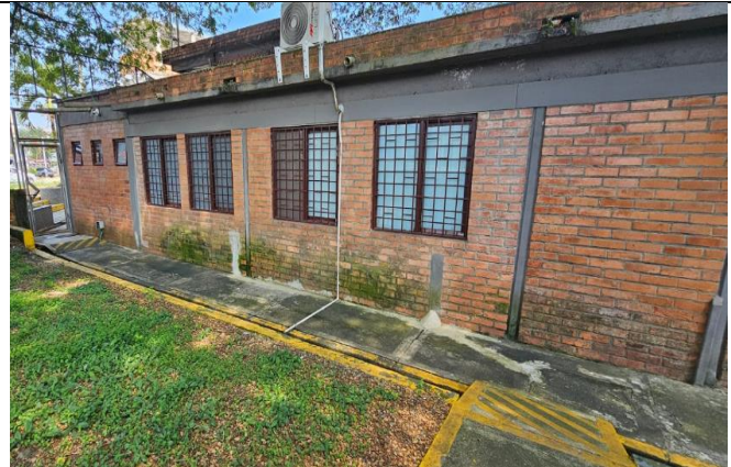
Humedad en las paredes de los consultorios
