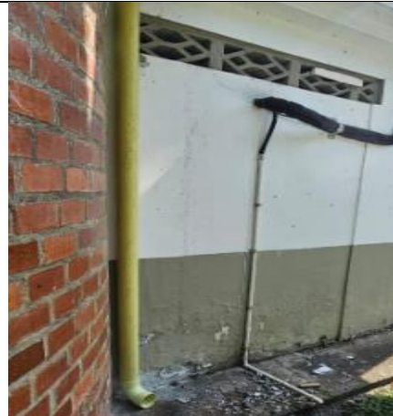
Humedad en paredes del consultorio 1.
