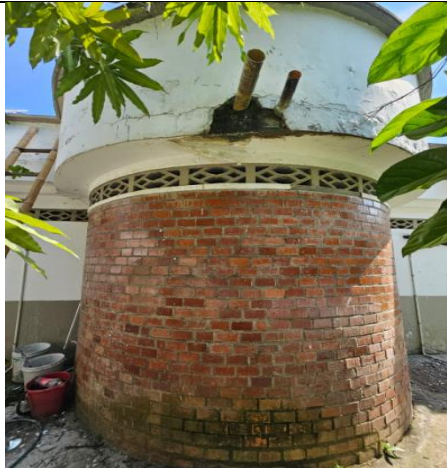
Paredes con humedad
