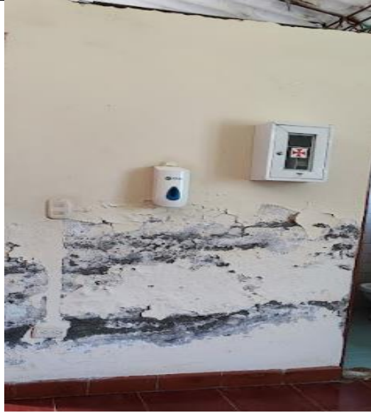
Pared con humedad, se requiere impermeabilización y enlucimiento a todo el punto de atención.
