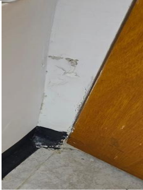
Humedad en laboratorio
