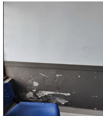
Humedad en las paredes de sala de espera
