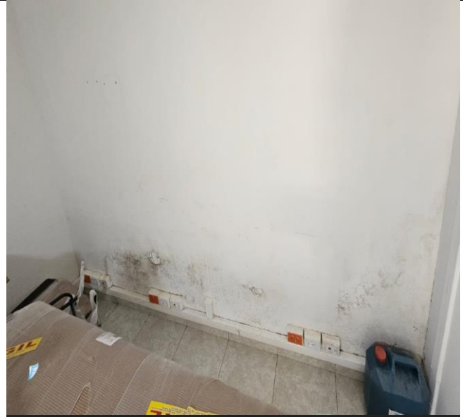
Humedad en consultorio
