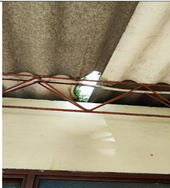
Tejas quebradas, estructura del techo oxidada
