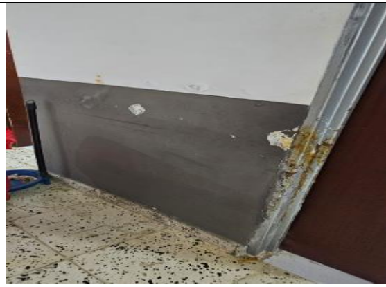
Deterioro de marco de puerta del cuarto de aseo por humedad.
