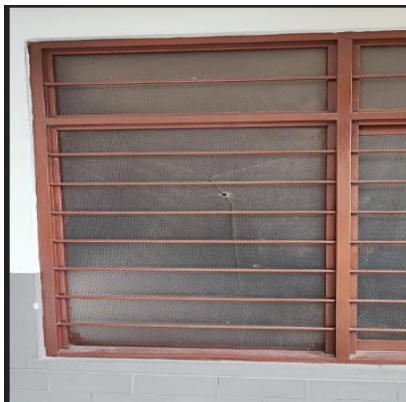
Hay ventanas con vidrios quebrados
