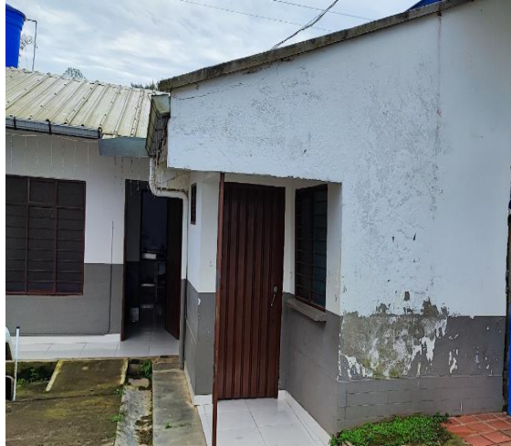
Se requiere enlucimiento a la fachada.
